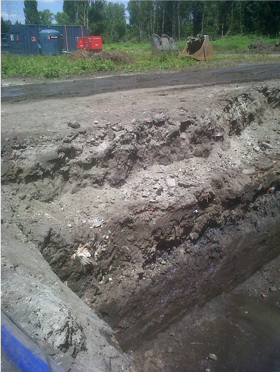
Figuur 6: Verstoring naar aanleiding van de saneringsactiviteiten (Arcadis Belgium nv)
