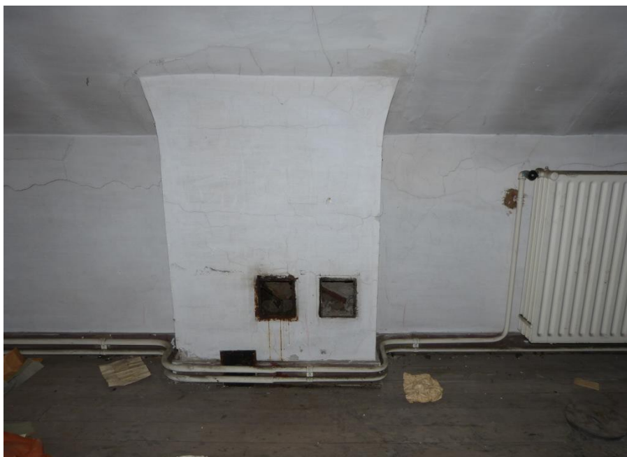
Fig. 39: Verluchtingsschouw op de zolderverdieping van blok B
